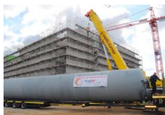
Kältespeicher mit 85 m 3 Inhalt, Durchmesser 2.60 m, Höhe 16 m.
