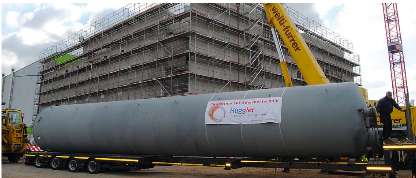
Kältespeicher: Inhalt 85 000 Liter, Durchmesser 2.60 m, Höhe 16 m.
